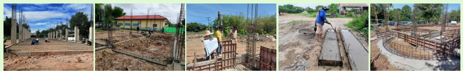
การดำเนินงานก่อสร้างอาคารเรียน โรงเรียนอนุบาล เทศบาลตำบลลพบุรี และ โรงเรียนสันป่าตองเทศบาลตำบลลพบุรี 1 และงานก่อสร้างอื่น ๆ ของกองช่าง เทศบาลตำบลลพบุรี
